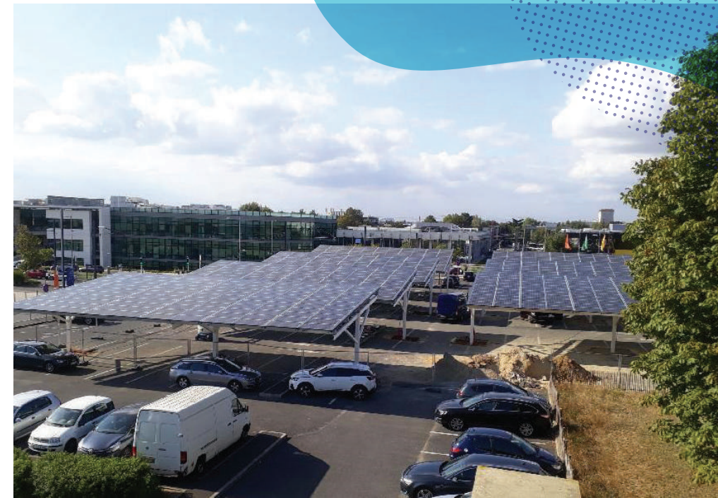
Ombrières photovoltaïques, Parc Paris Orly-Rungis (Val-de-Marne)
